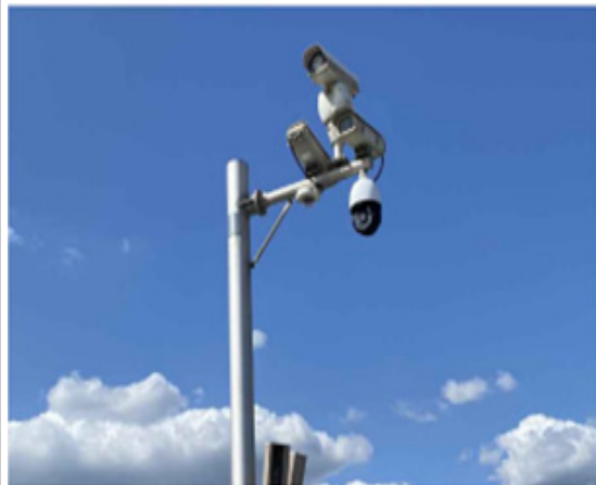
교량에 설치된 CCTV
